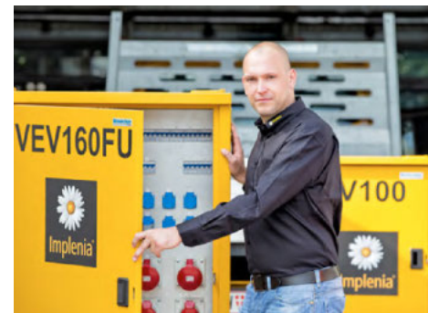
Michael Doppler, chef électricien génie mécanique de la succursale de Vienne, applique aux conteneurs de chantier dotés du système i-Cont le principe «chauffer et aérer uniquement dans la mesure nécessaire».
